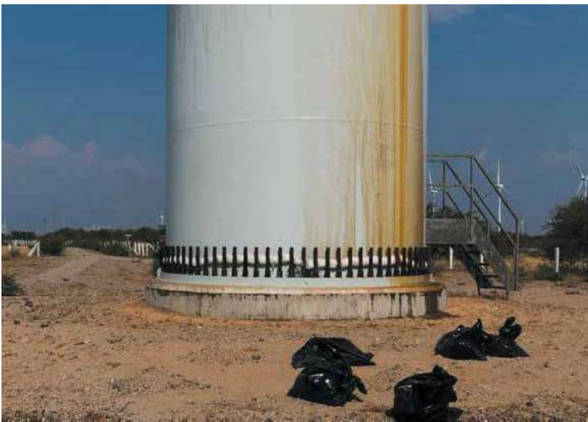
Eine „normale“ Ölsperre versagt bei der Schmierölaufnahme
